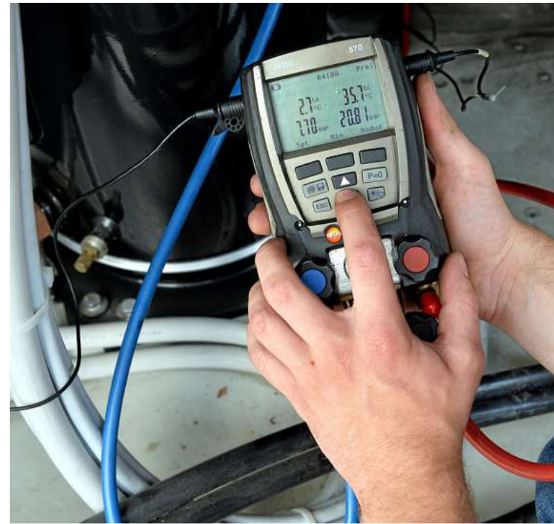
Druck und Temperaturen müssen kontrolliert werden.
