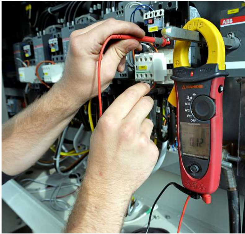
Der Spannungsprüfer kommt regelmäßig zum Einsatz.
