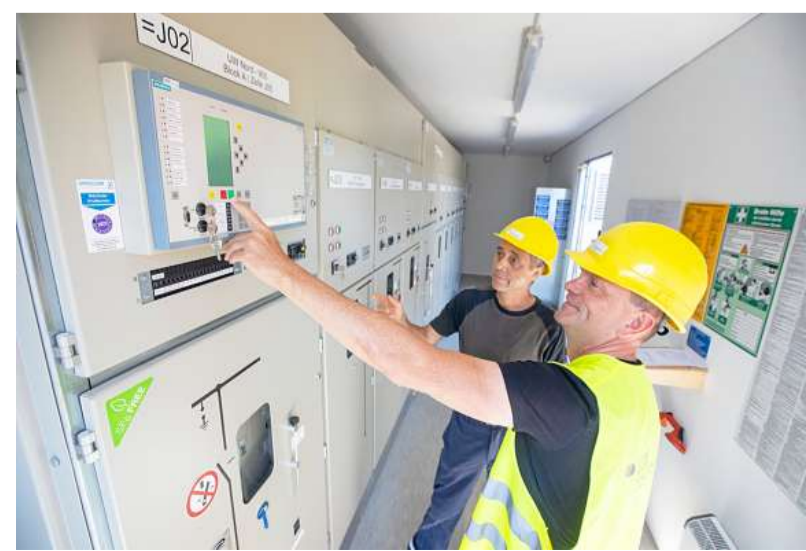
Mitarbeiter der Energieversorgung Gera, André Jentsch (vorn) und Mario Günther, bei der Inbetriebnahme des Schalthauses.
