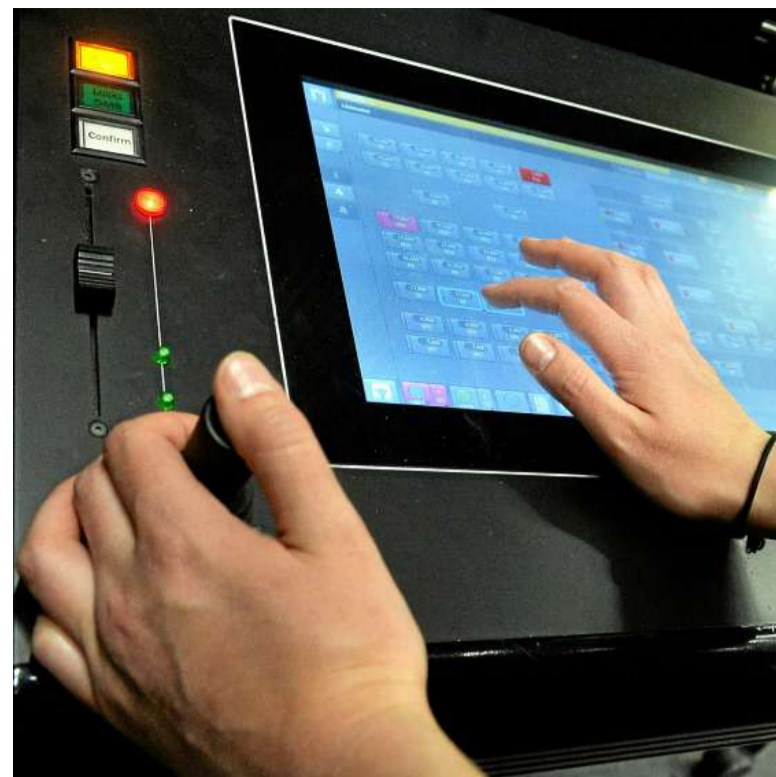
... und am Steuerpult der Bühnenmaschinerie.
