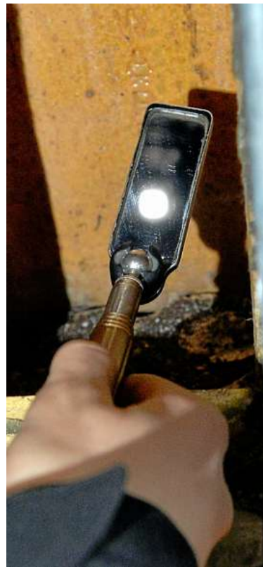
Der Spiegelblick in den Abzug gehört zur Abgaswegekontrolle.
